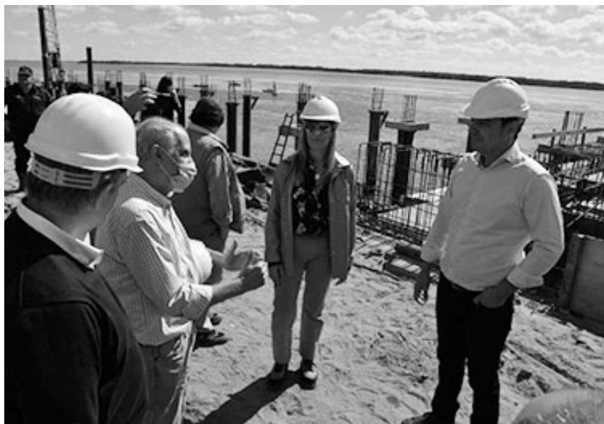
Gustavo Valdés, gobernador correntino, recorrió las obras del puerto en mayo, acompañado de la ministra Gabur.
